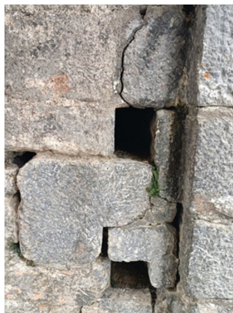
Fissure dans les maçonneries du château de Montségur probablement due à un impact de foudre
